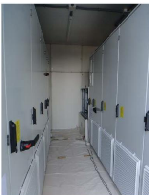
【ABBパワコン設置状況】
